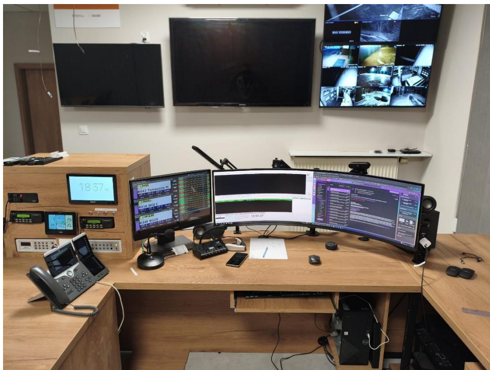
Zdjęcie nr 31. Widok na nowopowstałe stanowiska dyspozytorskie SK KP PSP
